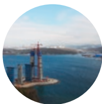
Электроснабжение саммита стран АТЭС
