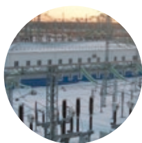
Энергетическое кольцо 330 кВ в Санкт-Петербурге
